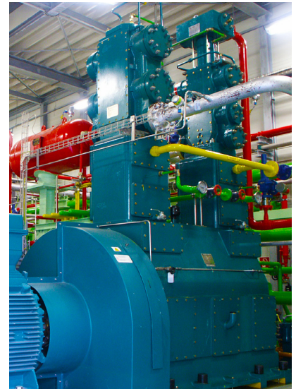
Einer der beiden Hochdruck-Wasserstoff-kompressoren - zuverlässig im Einsatz seit 2001.
