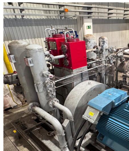
Von Verschleiss zu Zuverlässigkeit – die Kompressoren sind bereit für den Langzeitbetrieb.
