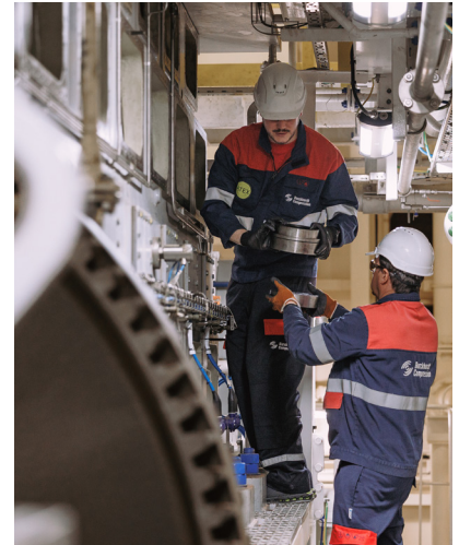
Wartung des Kompressors während des Dry-docks.
