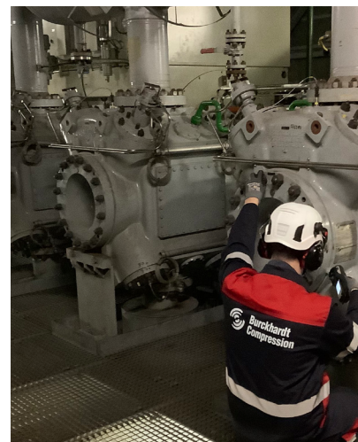
Lokaler Burckhardt Compression Monteur während einer detaillierten Vor-Ort-Inspektion..
