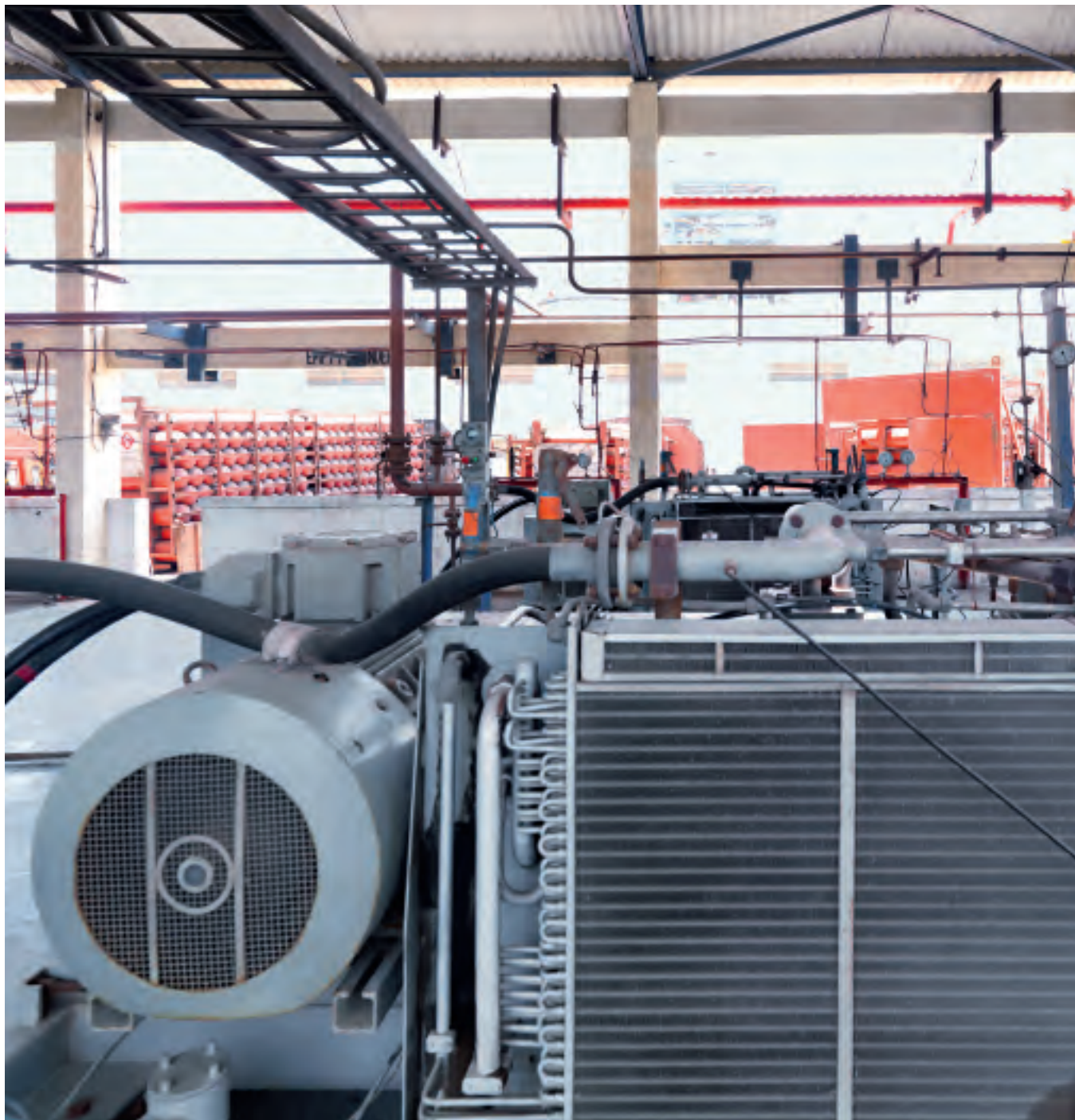
Компрессор CU, удовлетворяющий самым высоким стандартам безопасности, на станции фасовки водорода
