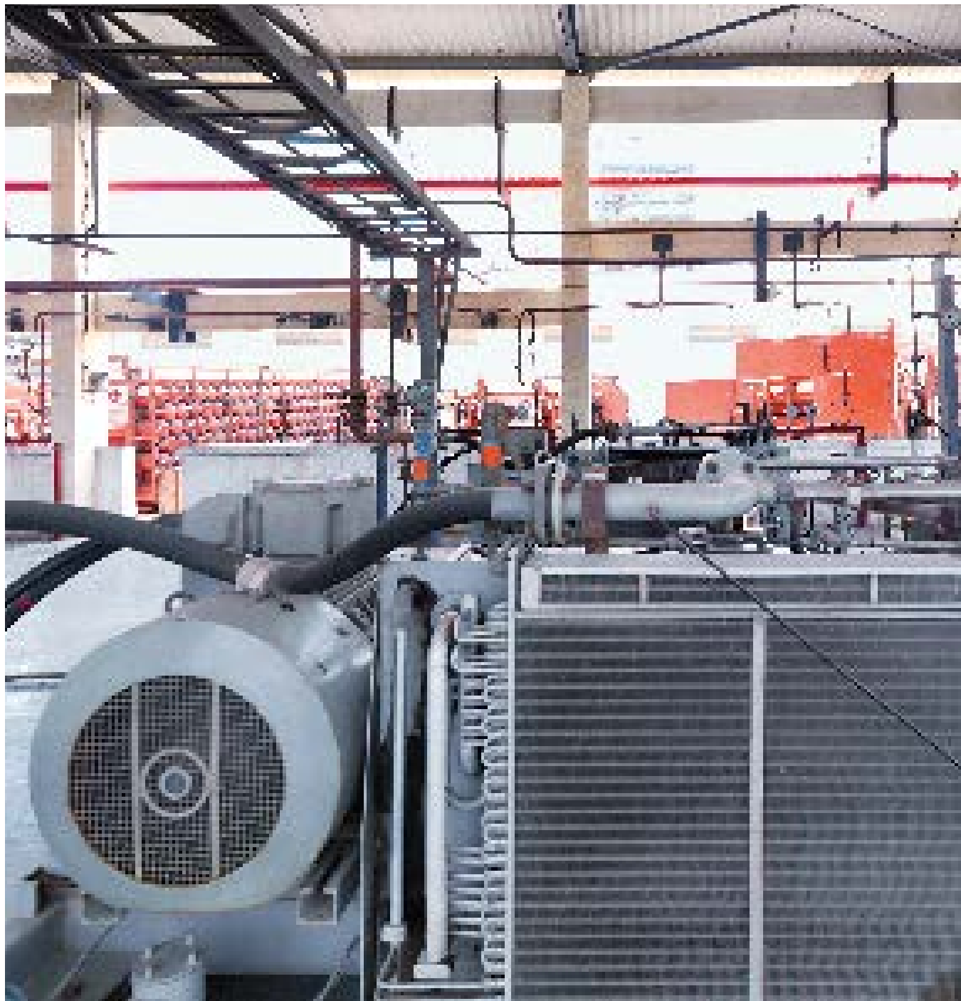
水素ボトリングプラントでの厳格な安全基準を満たす CU 圧縮機
